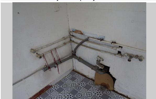
Rozvody vody a odpadu v kuchyni
